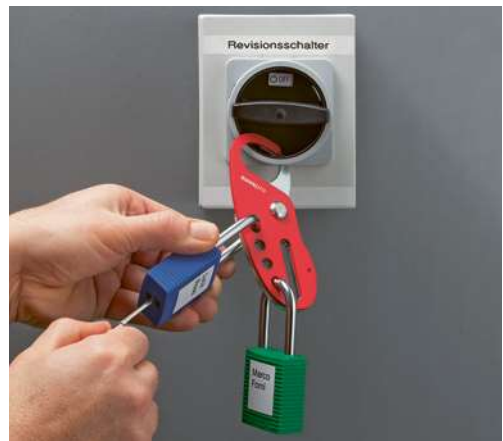
1 Gesicherter Revisionsschalter mit Vorhängeschloss und Mehrfach-Schliessbügel
