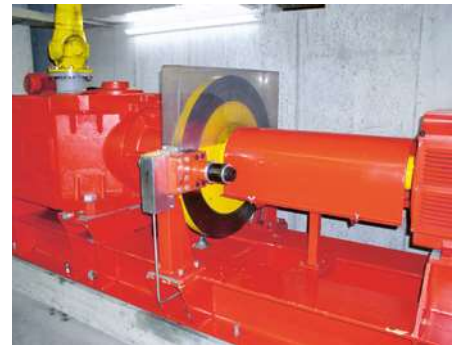
10 Drehende Teile an der Antriebsmaschine mit Schutzabdeckung gesichert
