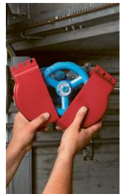
3 Absperrung für Ventil
